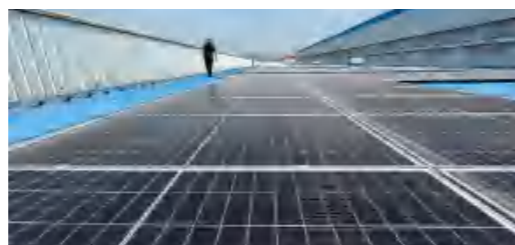
重庆总装铺设厂区屋顶光伏
