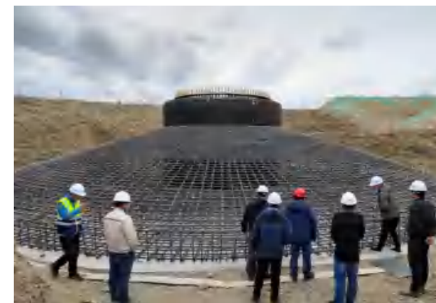
新疆海为达坂城风电场升级改造项目通过首次塔筒吊装前质量监督检查
